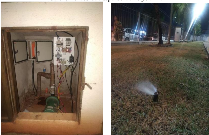
Figura 17 a, b e c – Figuras ilustrando o quadro do comando inserido no local de acionamento da bomba e acionamentos dos aspersores no jardim.
