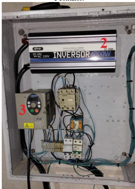
Figura 8 – Quadro metálico de 1,6 x 1,1 x 0,4 m para acomodação do conversor DC-monofásico, trifásico, proteções e contator.
