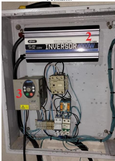
Figura 8 – Quadro metálico de 1,6 x 1,1 x 0,4 m para acomodação do conversor DC-monofásico, trifásico, proteções e contator.
